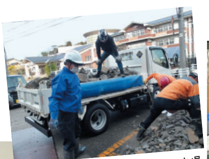
ボランティアが壊れたブロック塀を運びます (津幡町)
